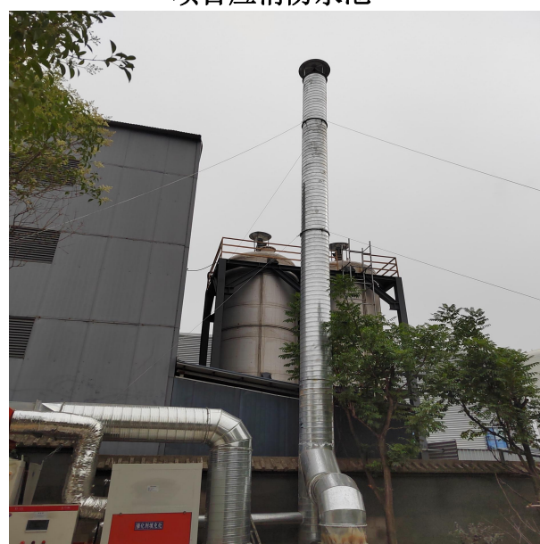
项目裂解工序废气处理设施排气筒
