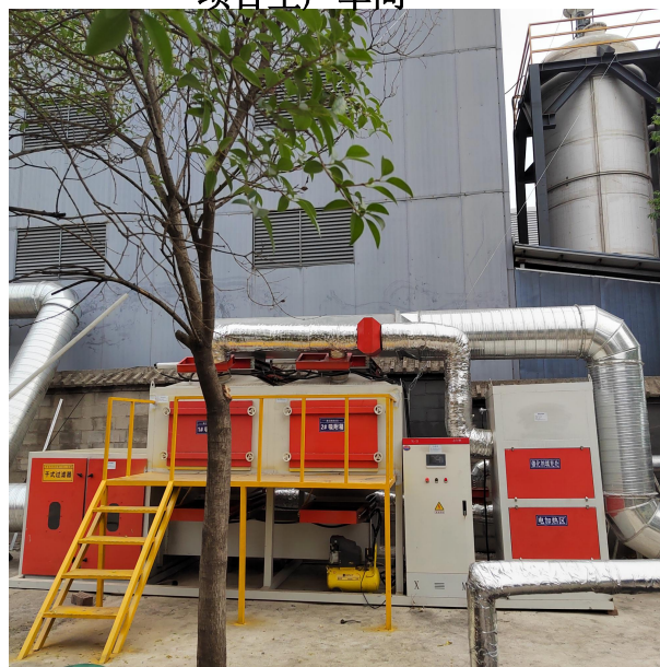
项目裂解工序废气处理设施
