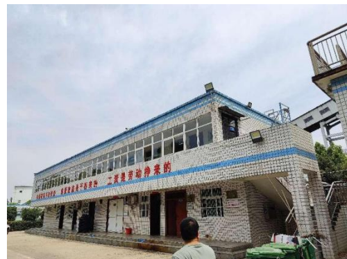
厂区内现有泵房及配电室
